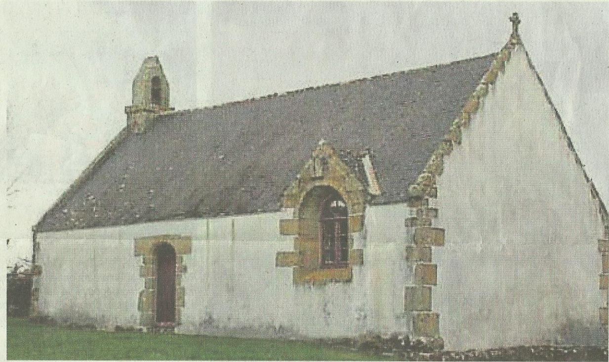
La toiture de la chapelle doit être changée, peut-être aussi la charpente.
